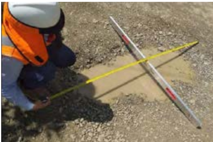
Falla baches, dentro del tramo de estudio km 35+000- km 36+000, se aprecia niveles de severidad media y alta.
